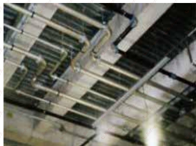
屋内給湯配管
